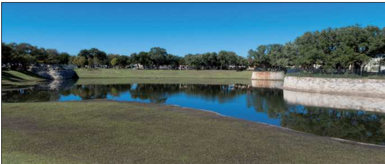
FIG. 123 Esempio di Bacino di detenzione riempito dopo una pioggia intensa.
