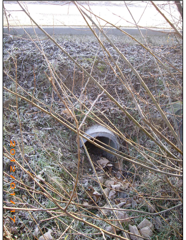
FIG.88 Particolare tubazione di drenaggio pista ciclopedonale su via S. Dionigi
