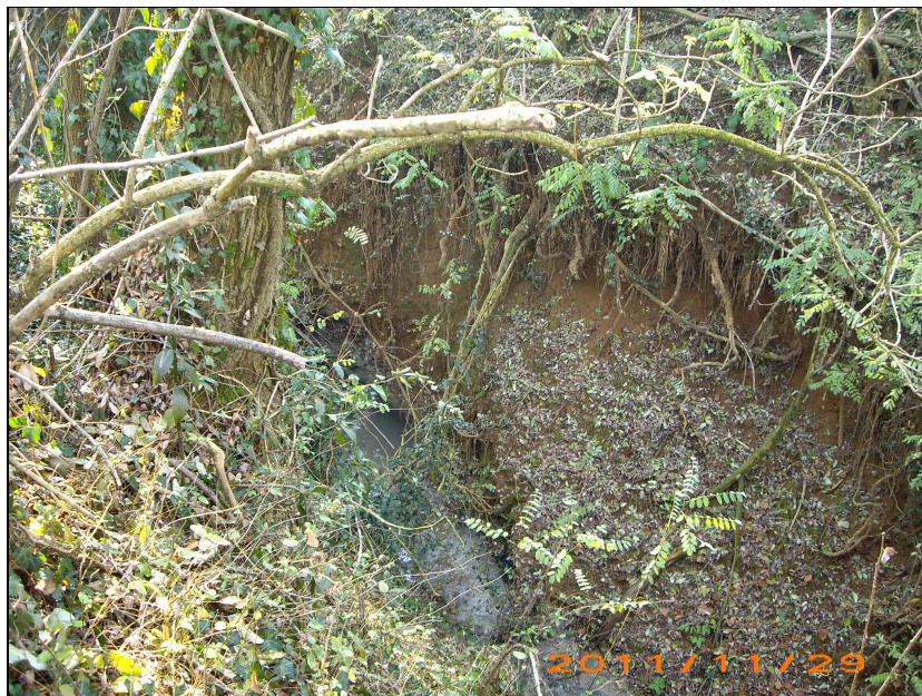
FIG.102 Particolare sponda in forte erosione
