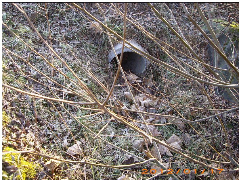
FIG.95 Particolare tubazione di drenaggio pista ciclopedonale su via S. Dionigi
