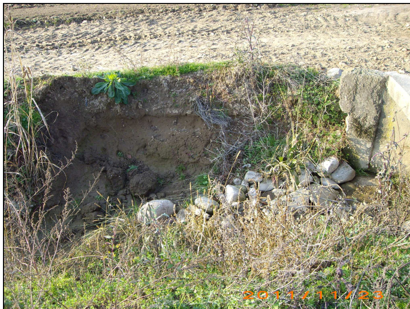
FIG.35 Particolare roggia n.3 erosione spondale
