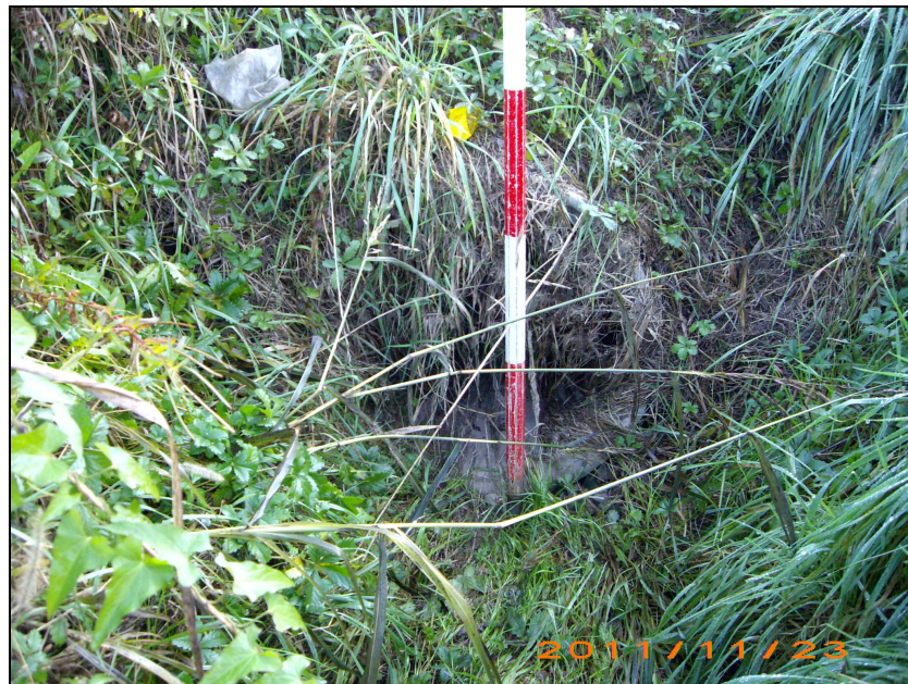
FIG.46 Tombamento ostruito canale adiacente via Fontanella in loc. Cascina Maria
