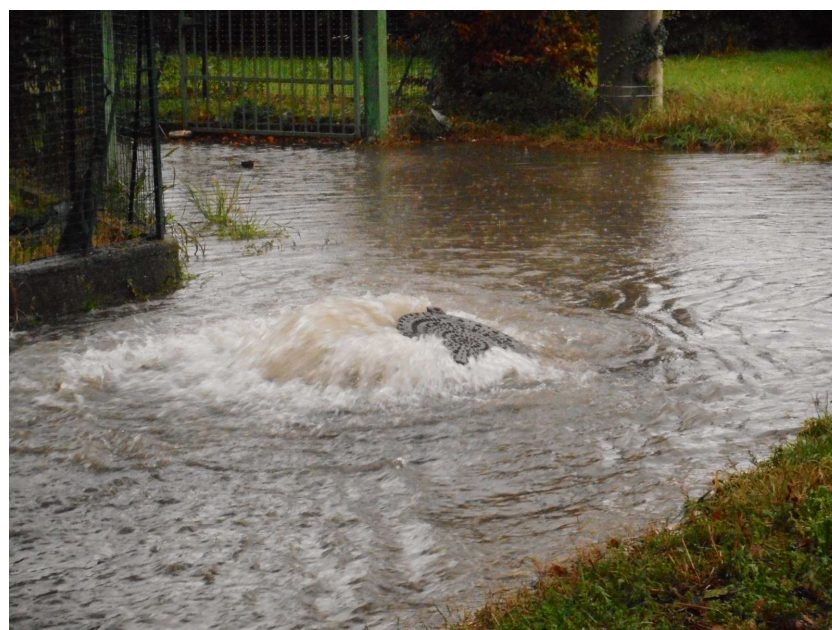
Fig. 116 Rigurgito Collettore Fognario presso isola Ecologica
